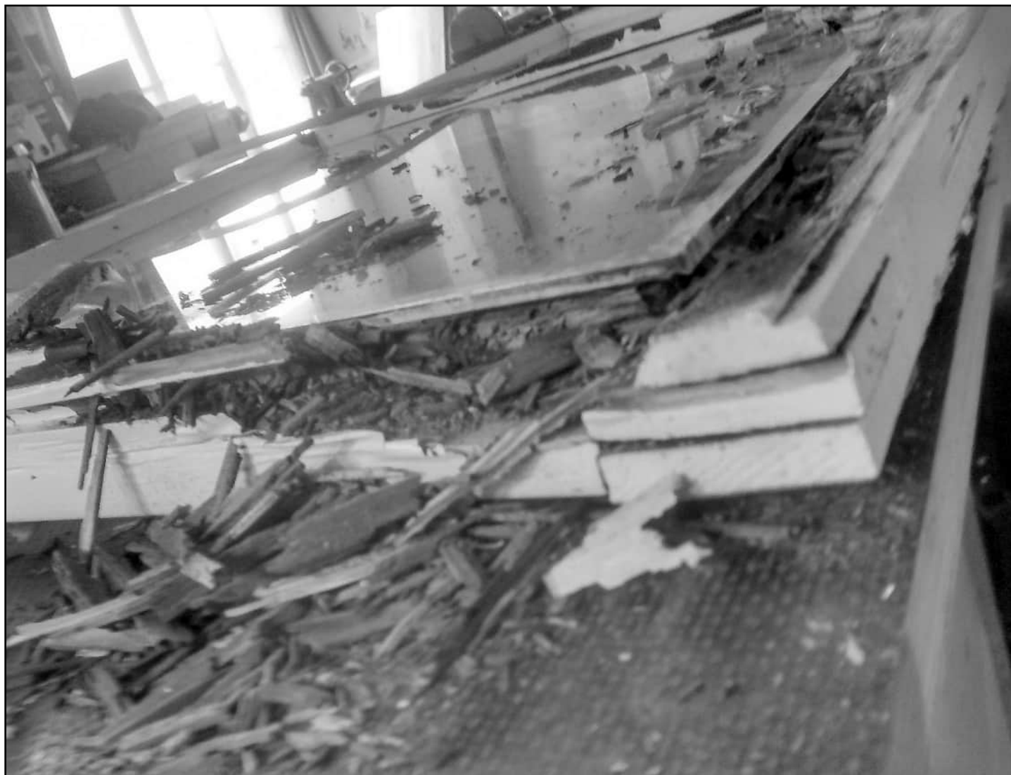
Päällisin puolin hyvältäkin näyttävä ikkuna saattaa tarkemmin tutkittaessa osoittautua vakavasti kosteusvaurioituneeksi.
